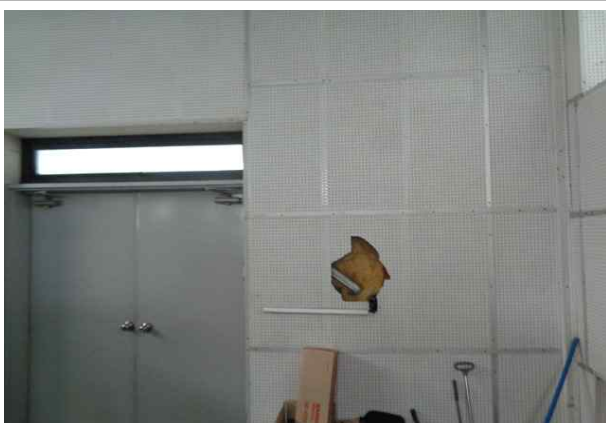
내부 벽체 판넬 파손 (A=0.2m×0.5m, 1EA)
