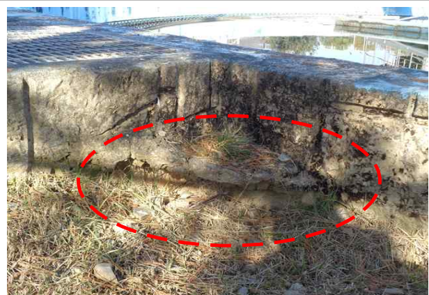
2지 외부 주변지반 공동 (A=1.0m×1.0m)
