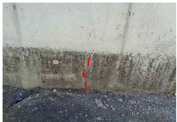
외부 벽체, 균열 (CW=0.5mm, L=0.3m)
