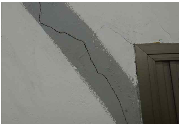
내부 1층 전기실 벽체 균열 (CW=0.5mm, L=1.5m, 17EA)
