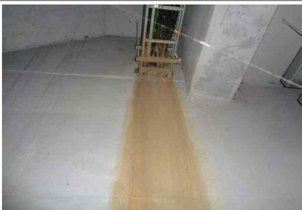
내부 지하층 벽체 누수흔적 (A=0.5m×3.0m)
