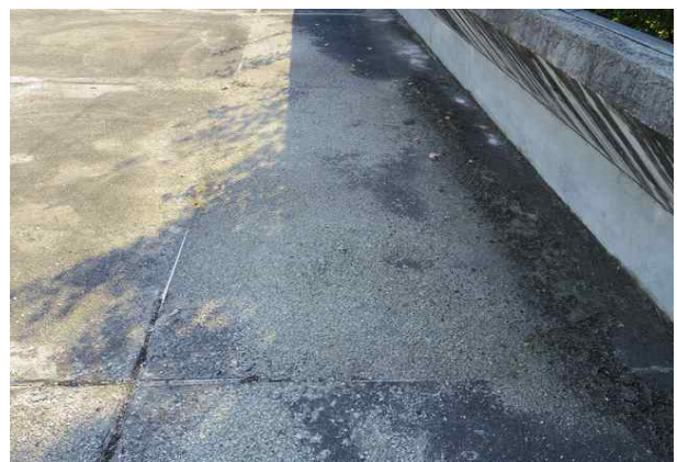
옥상층 바닥 콘크리트 박리 (A=30.0m×10.0m)
