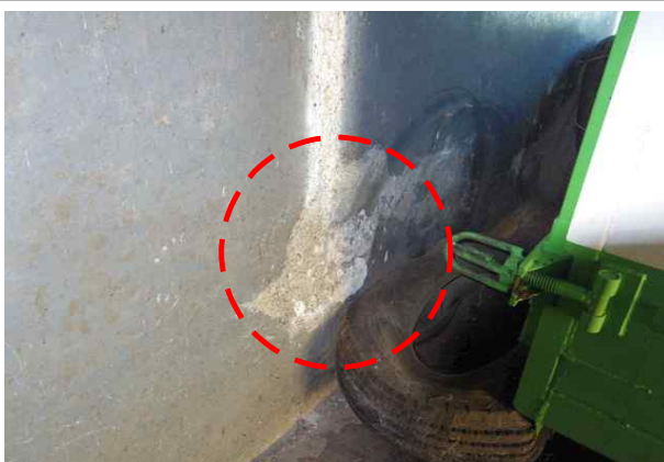
내부 1층 벽체 콘크리트 박락 (A=0.5m×0.5m)
