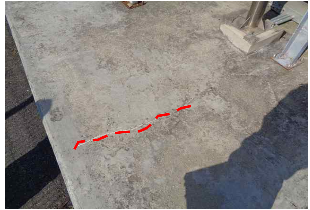
외부 바닥 균열 (CW=0.2mm, L=0.5m)
