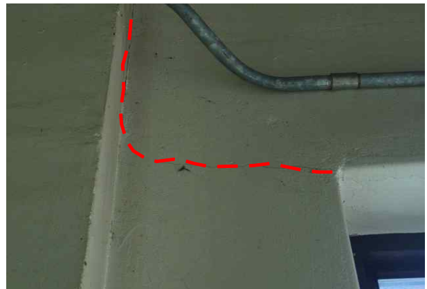
내부 2층 벽체 균열 (CW=0.2mm, L=1.5m, 3EA)
