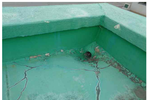
옥상층 바닥 마감재 들뜸 (A=1.0m×1.5m)
