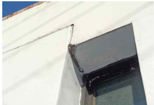
외부 벽체 파손 (A=0.1m×0.1m)
