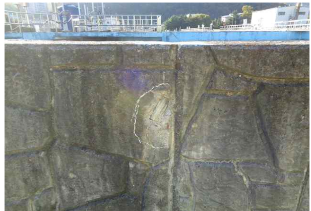
2지 외부 벽체 콘크리트 박락 (A=0.2m×0.3m)
