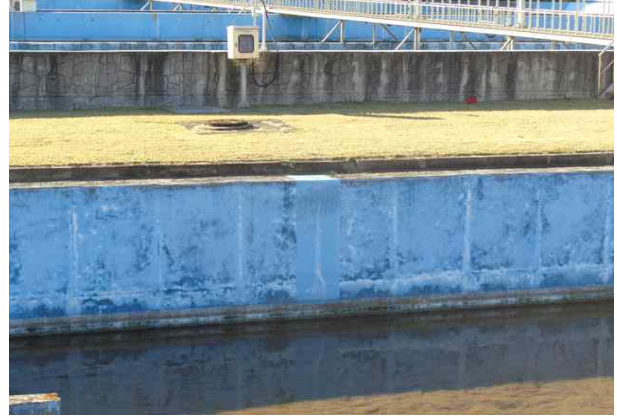
1지 내부 벽체 균열 및 백태 (L=2.5m, 134EA)
