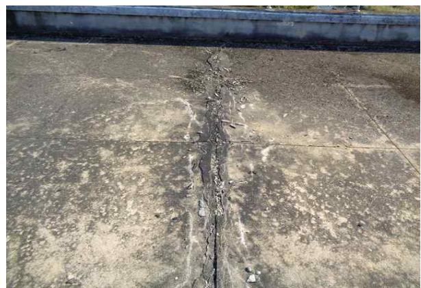
옥상층 바닥 박리 및 들뜸 (A=10.0m×11.0m)
