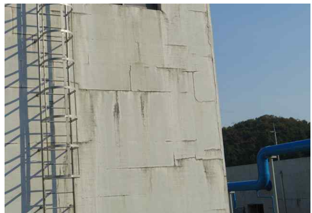
외부 벽체 마감재 손상 (A=10.0m×15.0m)
