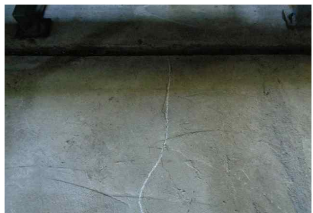
유입펌프장 지하층 바닥 균열 (CW=0.3mm, L=3.0m)
