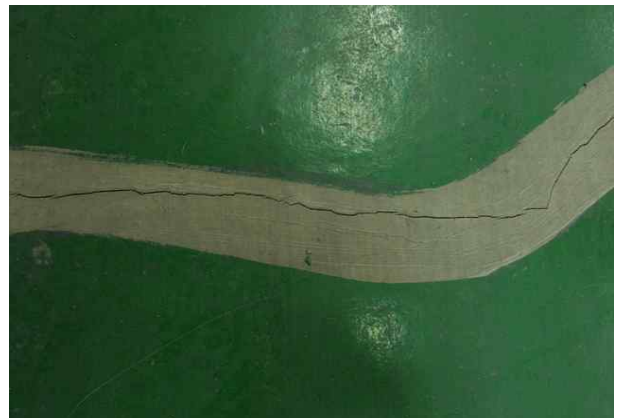
내부 1층 전기실 바닥 균열 (CW=0.5mm, L=2.0m, 14EA)
