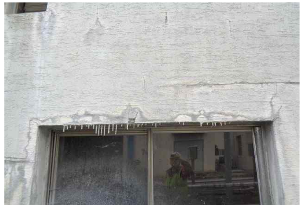
외부 벽체 백태 및 누수흔적 (A=2.0m×0.1m)
