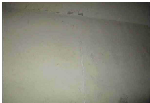
내부 벽체 균열 및 백태 (L=2.5m, 2EA)
