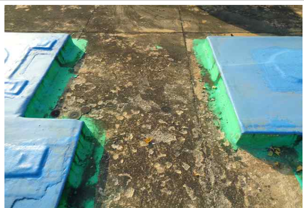
옥상층 바닥 표면박리 (A=6.0m×12.0m)
