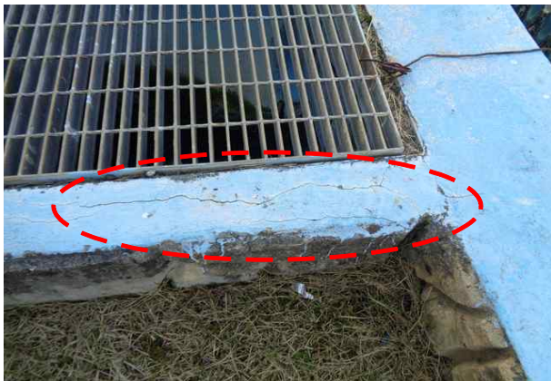
외부 벽체 콘크리트 박리 (A=0.2m×1.0m)
