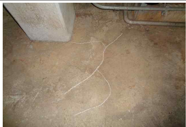
지하층 바닥 균열 (CW=0.2mm, L=1.5m)
