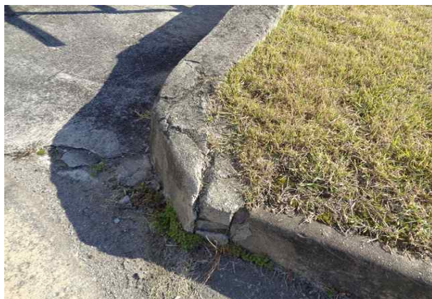
외부 도로경계석, 콘크리트 파손 (A=0.3m×0.3m)
