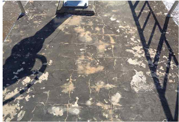
1지 외부 바닥 박리 및 망상균열 (A=2.5m×3.0m)
