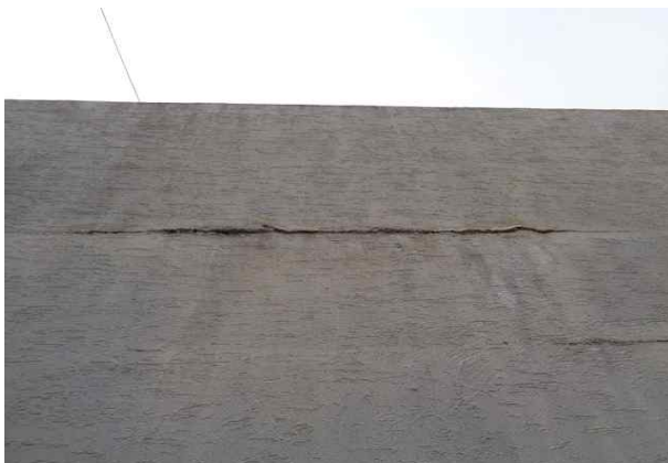
외부 벽체 마감재 균열 및 백태 (L=1.5m, 3EA)
