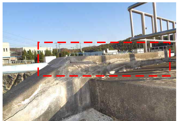
1지 외부 계단 콘크리트 박락 (A=0.3m×1.0m, 2EA)
