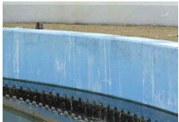
2지 내,외부 벽체 균열 및 백태 (CW=0.2m, L=0.5m, 64EA)
