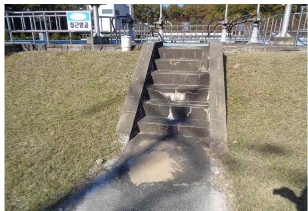
2지 외부 계단 콘크리트 파손 (A=0.3m×0.3m)
