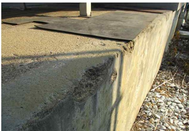
외부 벽체 콘크리트 파손 (A=1.0m×0.1m)
