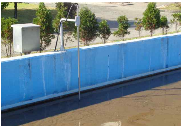
1지 내부 벽체 균열 (CW=0.2mm, L=2.5m, 90EA)
