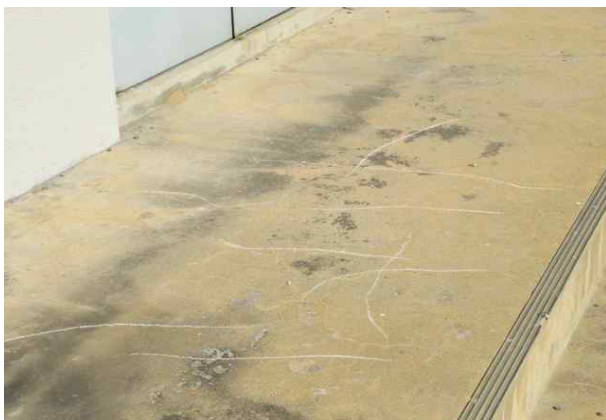
외부 출입구 망상균열 (A=10.0m×2.0m)
