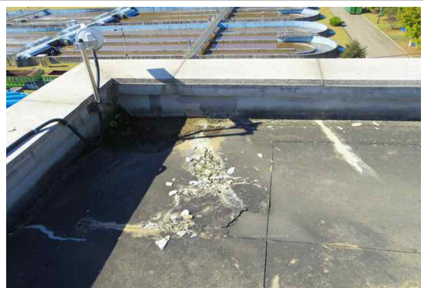
옥상층 바닥 콘크리트 박락 (A=1.0m×1.0m, 2EA)
