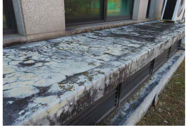
외부 환기구 콘크리트 들뜸 (A=1.5m×1.5m)
