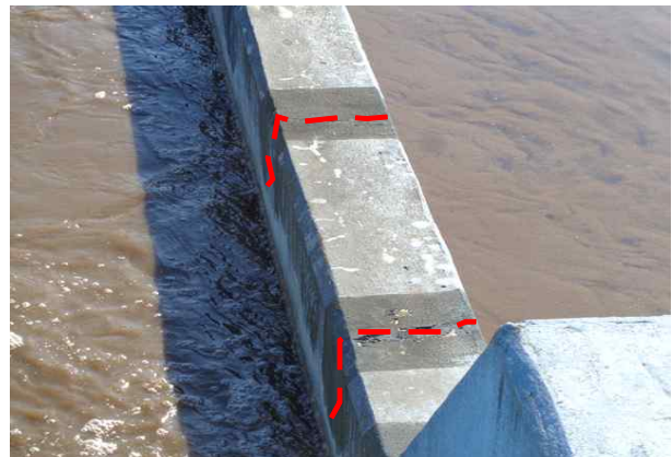
1지 내부 벽체 균열 (CW=0.2mm, L=0.5m, 150EA)
