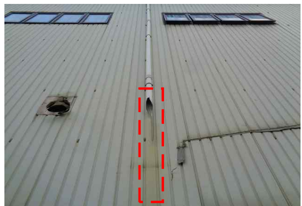
외부 벽체 배수관 파손 (L=5.0m)
