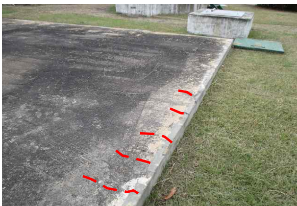
외부 바닥 균열 (CW=0.2mm, L=0.5m, 12EA)
