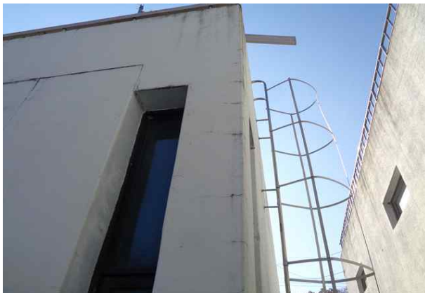
외부 벽체 균열 (CW=0.2mm, L=1.0m, 12EA)
