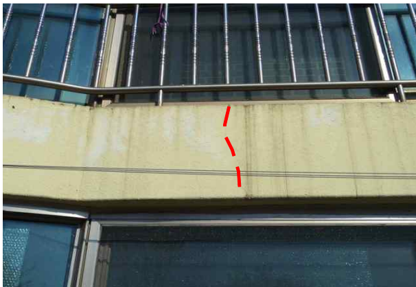
외부 벽체 균열 (CW=0.2mm, L=0.5m, 7EA)
