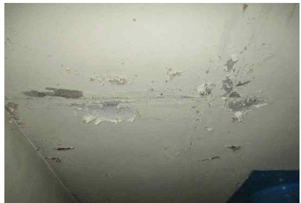
내부 지하층 천장 누수흔적 및 도장박리 (A=1.0m×1.0m)
