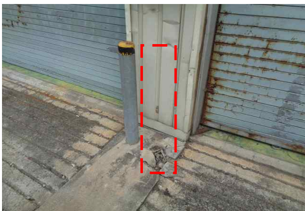
외부 충돌방지시설 파손 (1EA)
