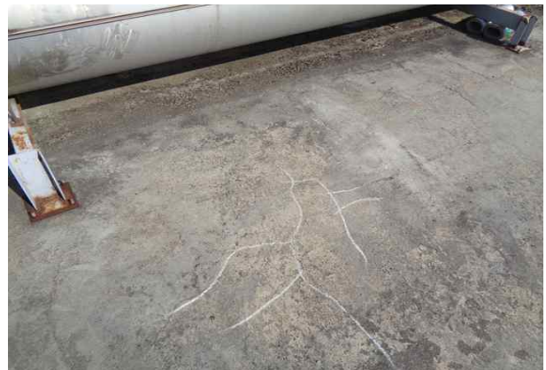
외부 바닥 망상균열 (A=1.0m×0.5m)
