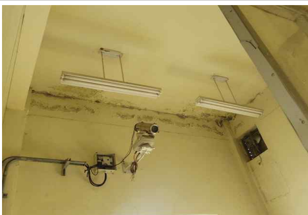
내부 2층 벽체 누수 흔적 (A=20.0m×1.0m)
