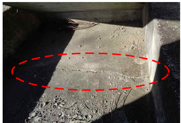
외부 계단 하부, 들뜸 (A=1.5m×0.1m)
