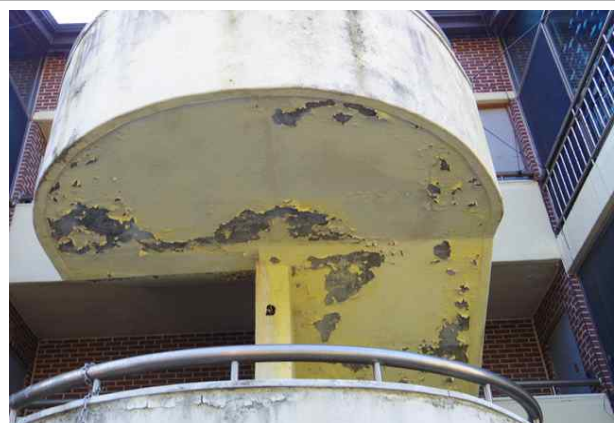
내부 2층 계단부 도장박리 (A=3.0m×0.1m)
