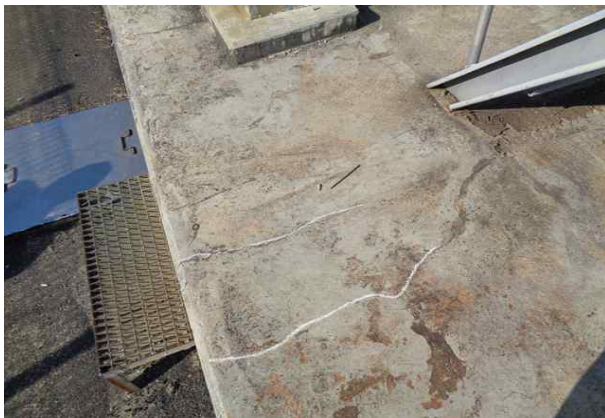
외부 바닥 균열 (CW=0.2mm, L=0.5m)
