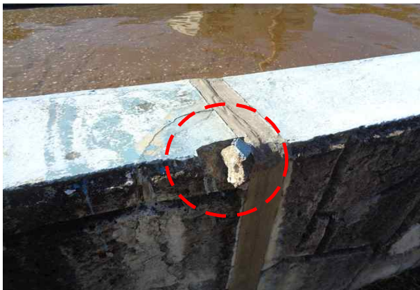
1지 외부 벽체 조인트부 콘크리트 박락 (A=0.2m×0.2m)
