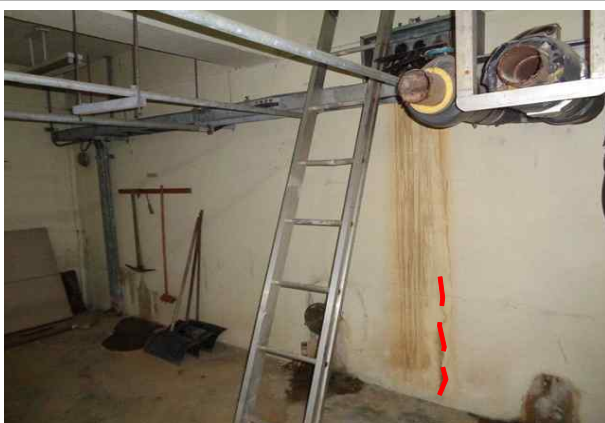
내부 지하층 벽체 균열 및 누수흔적 (L=0.5m, 2EA)
