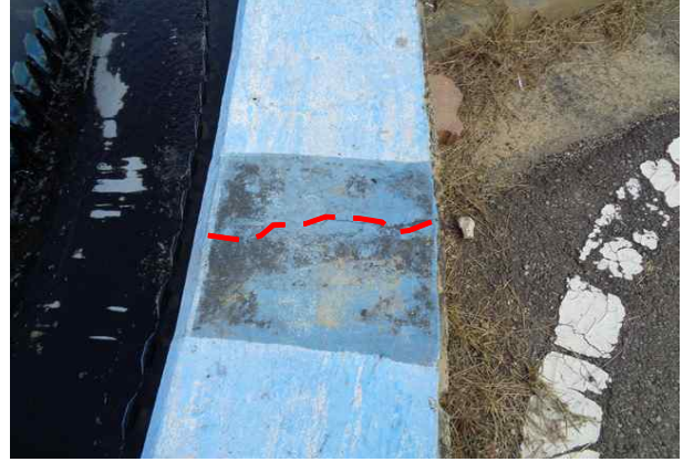
1지 내,외부 벽체 균열 및 백태 (CW=0.2m, L=0.5m, 68EA)
