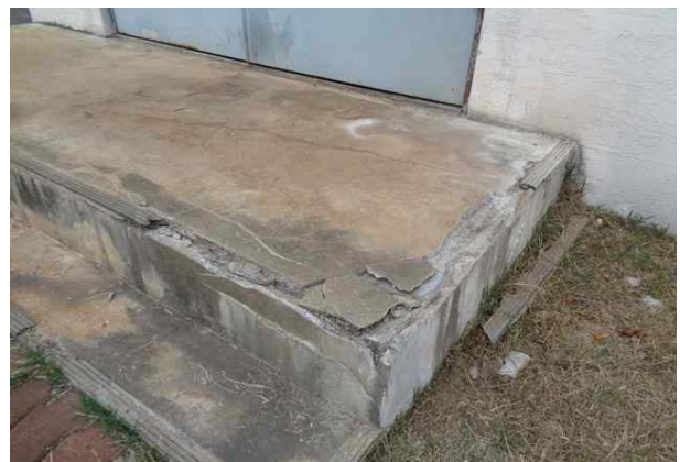
외부 출입구 마감재 박리 및 박락 (A=0.3m×1.5m)
