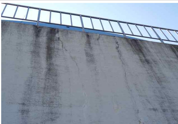
외부 벽체 균열 (CW=0.2mm, L=2.5m, 3EA)
