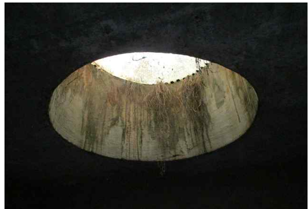
내부 천장 누수흔적 (A=0.3m×4.0m)
