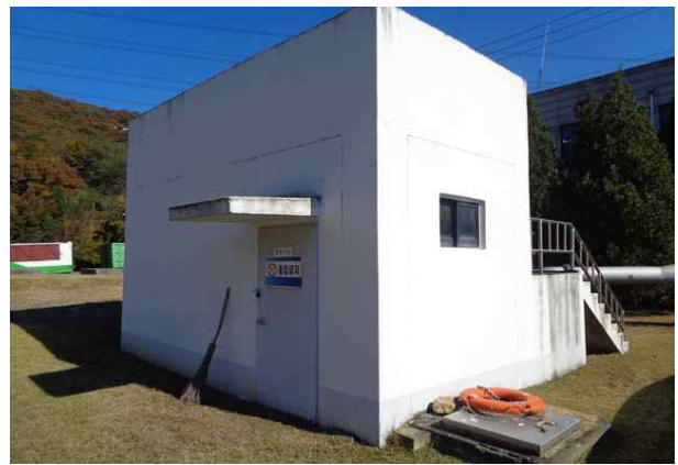
우수침전지 분배조 전경
