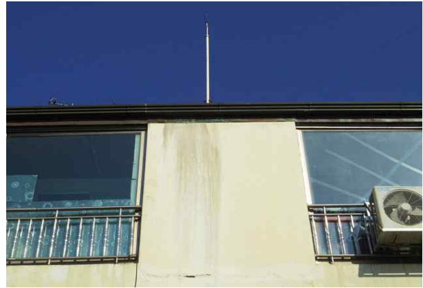
외부 벽체 누수흔적 (A=1.0m×3.0m)
