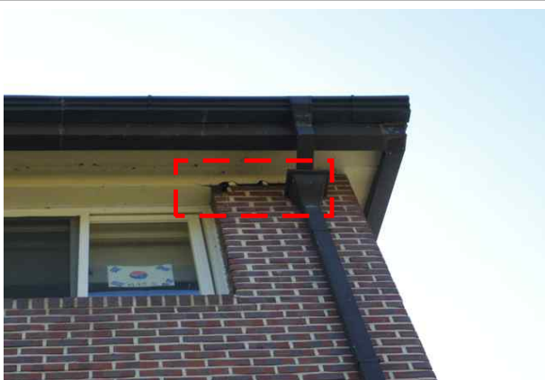
외부 벽체 콘크리트 들뜸 (A=0.5m×0.1m)
