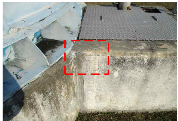
외부 벽체 콘크리트 들뜸 (A=0.1m×0.1m)
