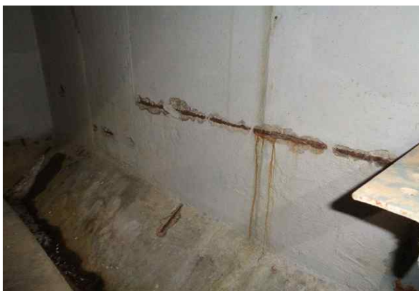
내부 지하층 벽체 철근노출 (A=0.2m×2.0m)
