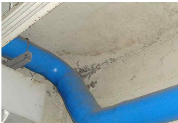
내부 천장 누수흔적 및 도장박리 (A=0.3m×4.0m)
